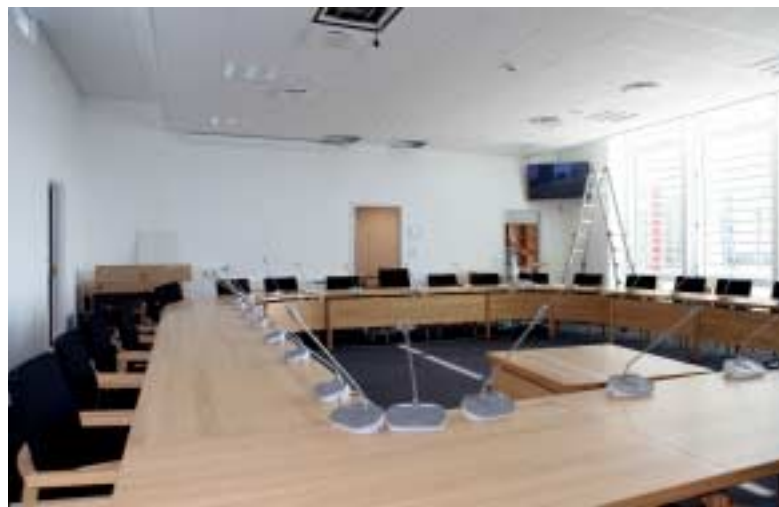
Byrådsalen er fuldt bestykt med avanceret AV-udstyr - installeret af Audio Visuelt Centrum A/S.
